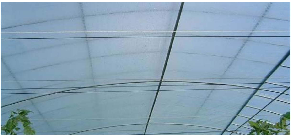
현장사진 2 : 내피 유적불량(표면에 물방울이 많이 맺힘)
