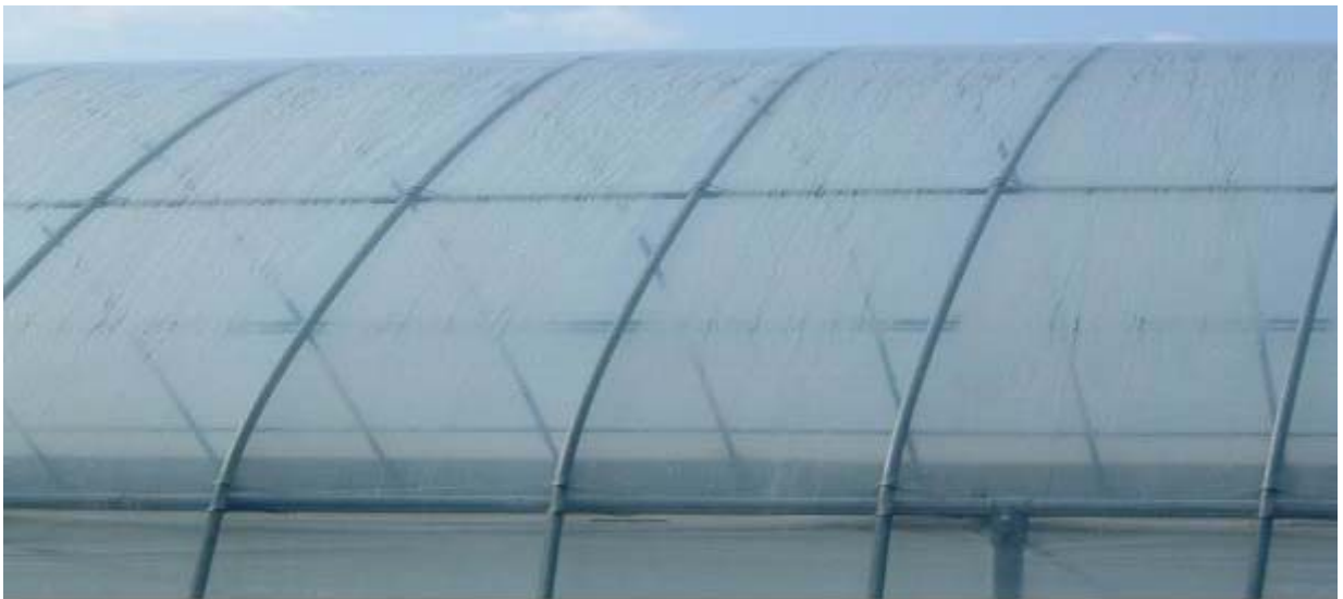
현장사진 1 : 단동 하우스로 피복 초기부터 유적상태 불량
