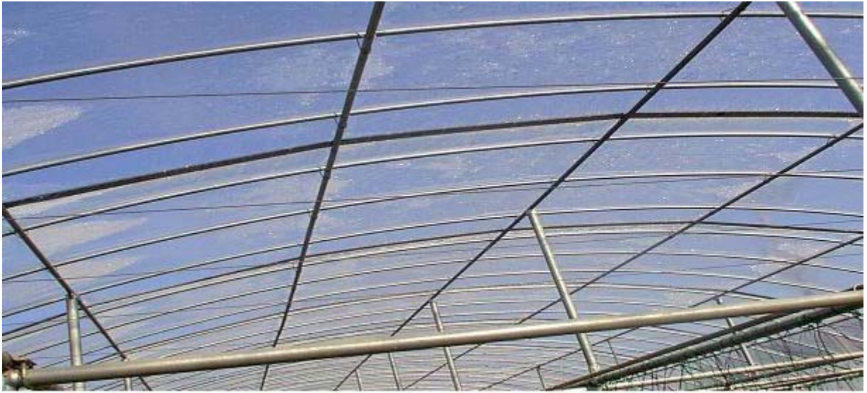
- 하우스 유적상태가 시포(설치) 초기부터 불량한 상태를 보임
