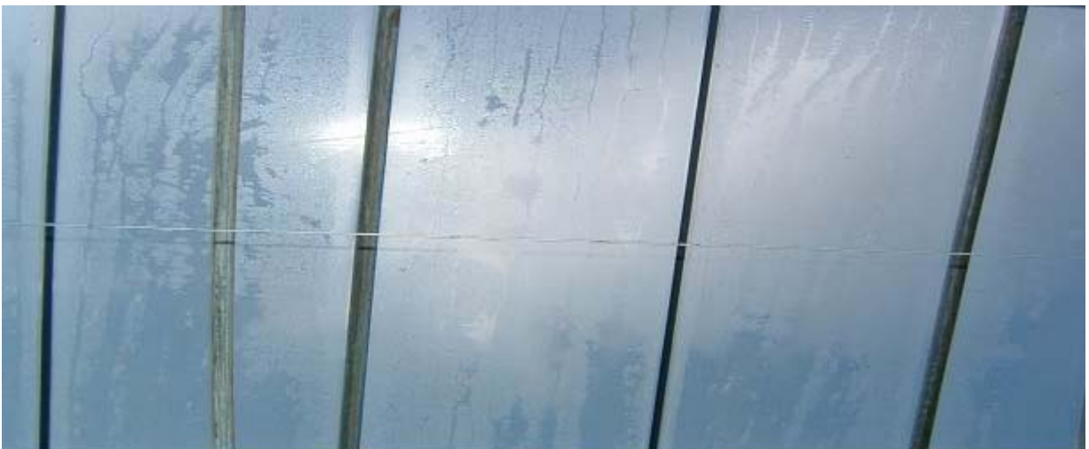
현장사진 2 : 필름표면에 코팅이 잘 안된 상태
