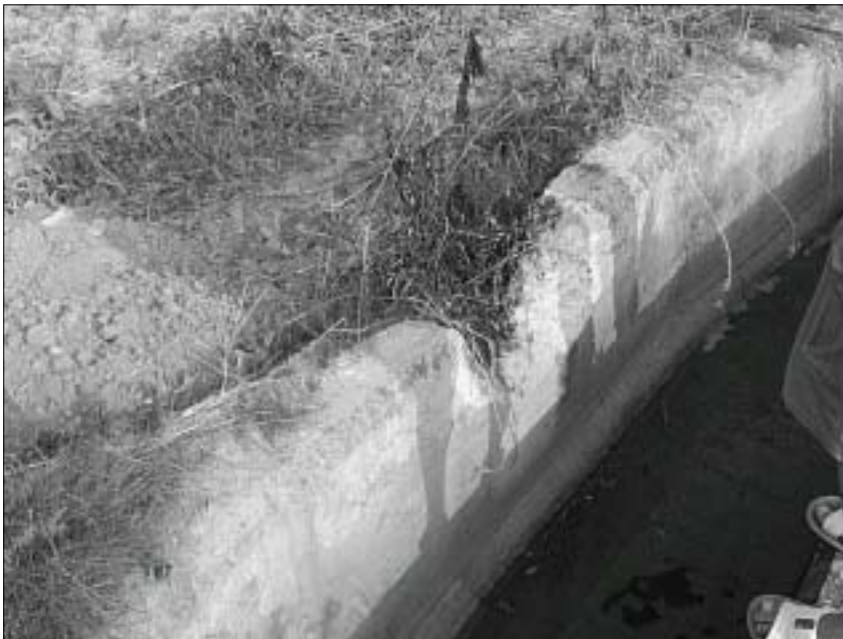
<그림 2-20> 운수지구 용수로 노선 중 파손구간 예
