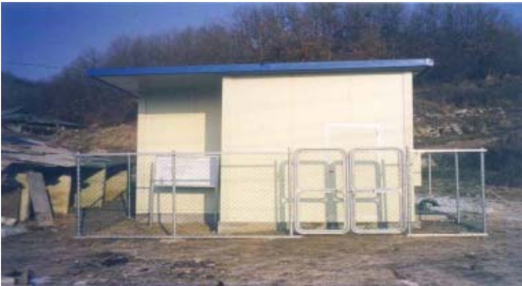
Fig 2-12. 목편칩을 이용한 오수처리 Pilot plant 시설
