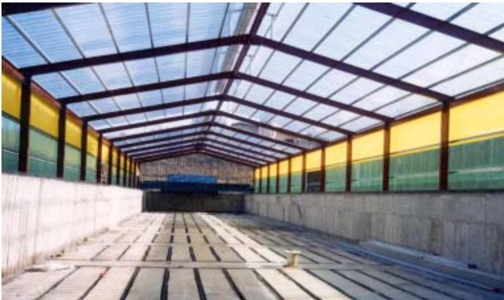
Fig. 4-13. 퇴비 발효시스템을 활용한 전처리 살수여상조의 산기관과 내부시설물
