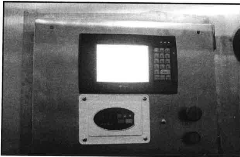
3) CONTROL PANEL의 외부 조작부 설치모습
