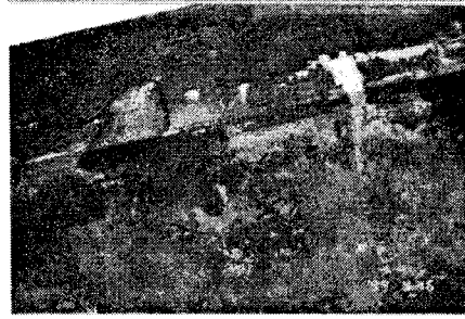
d. 슬래브와 측벽 이어치기 부위의 누수(1)
