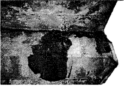
a. 슬래브 신축 이음부의 누수
