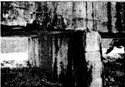
e. 기둥 손상(누수, 백화, 골재탈락, 철근노출 등) (1)
