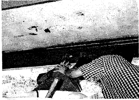
b. Stain Gauge 설치
