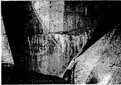
c. 옹벽 손상 (균열 및 백화)
