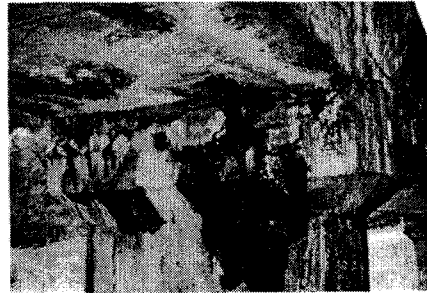
f. 기둥 손상(누수, 백화, 골재탈락, 철근노출 등) (2)
