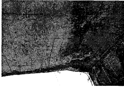
a. 슬래브 하부 누수 (2)
