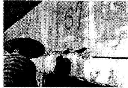
d. 골재 탈락 및 백화
