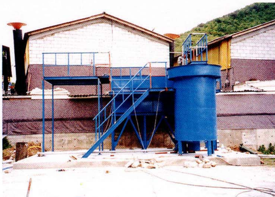
사진 2. 파일럿 플랜트 포기조 및 침전조 설치 현황
