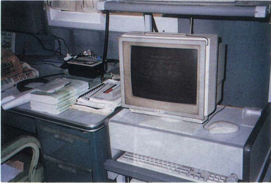
그림 6-5. 계측기지부 내부의 기상 데이터 수집장치 및 시스템제어장치
