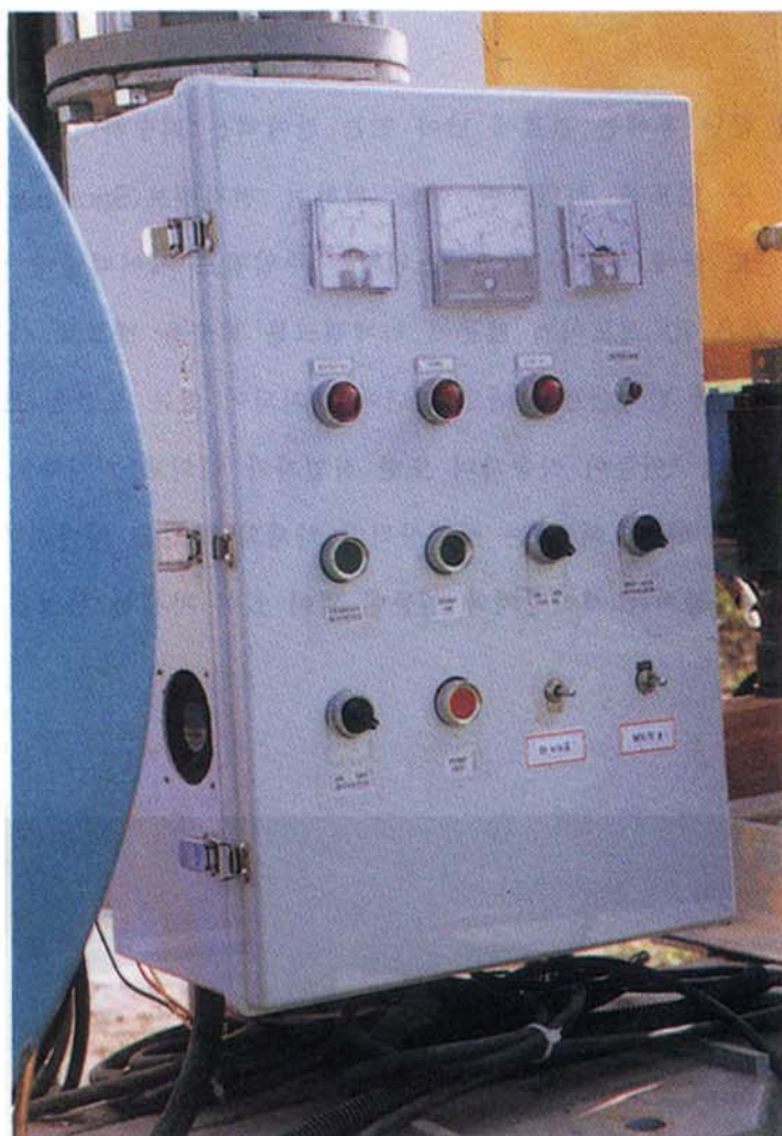
그림 4-12. 주입펌프 연동장치 패널에 설치된 전자밸브 스위치
