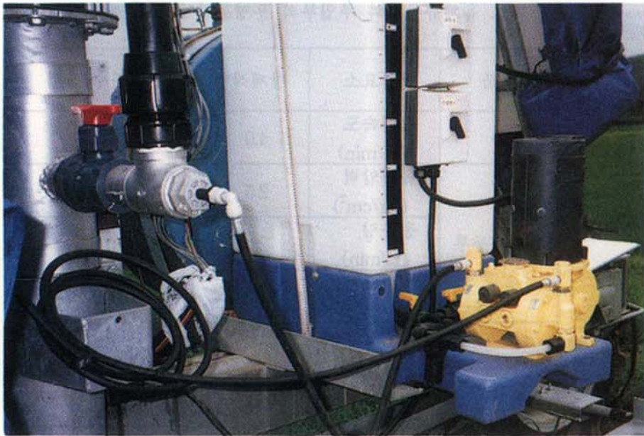
그림 4-9. Chemigation system 주입부의 주입펌프, 약액탱크 및 주입구
