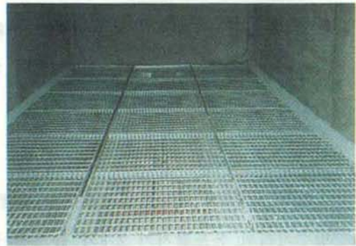
단기발효실 바닥 배관시설
