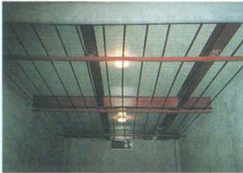
단기발효실 천장 배관시설
