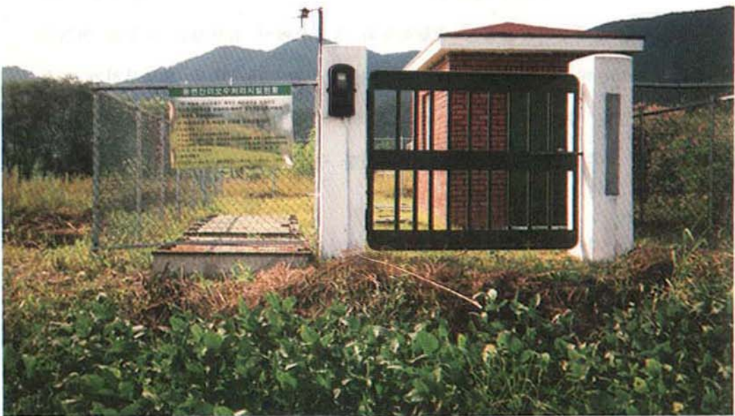
그림 3-2-3-2 접촉산화법에 의한 처리시설 전경(홍천군 동면 속초리 덕고개)
