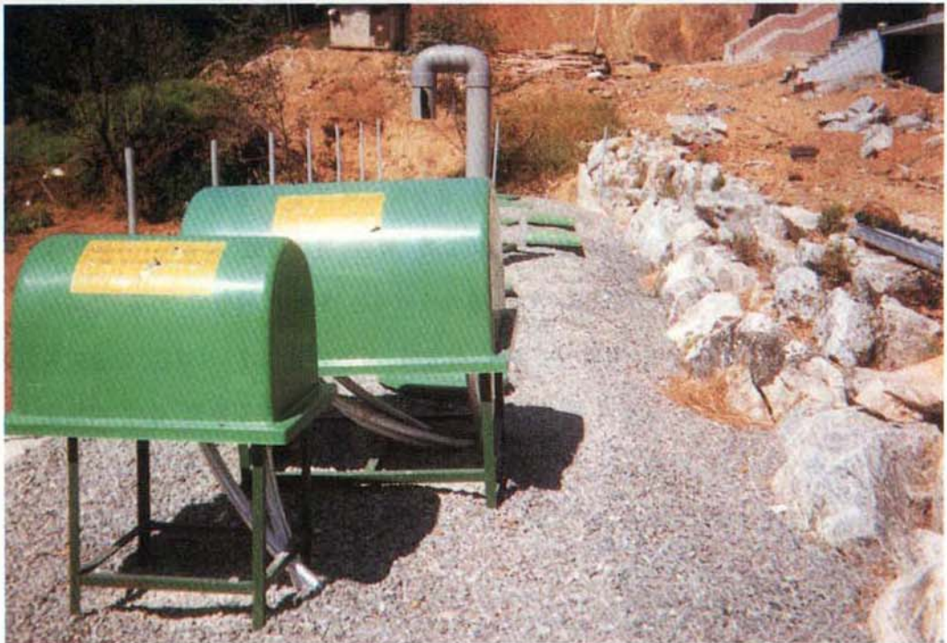
그림 3-2-3-10 고효율오수정화공법 시설 전경 (김포군 월곶면 포내2리 박골)
