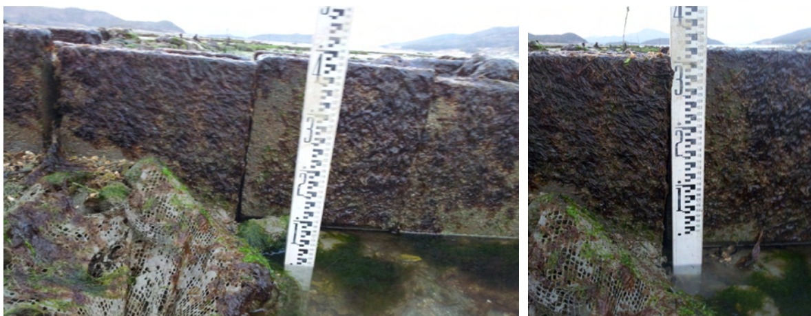
그림 3-4-7. 시공시 시공단차의 발생
