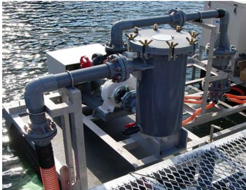
그림 132. 낙수방지 챔버와 구동수 펌프가 설치된 소형실험장치 모습
