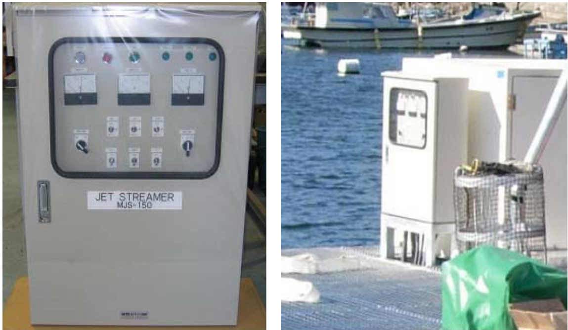
그림 200. 운전 제어판의 외관모습과 플로트에 설치된 모습
