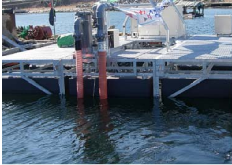
그림 258. 구동수 펌프 배관 호스와 해수 취수 배관 호스
