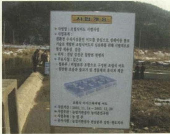
<그림 5-48> 현장에 설치된 사업개요 게시판
