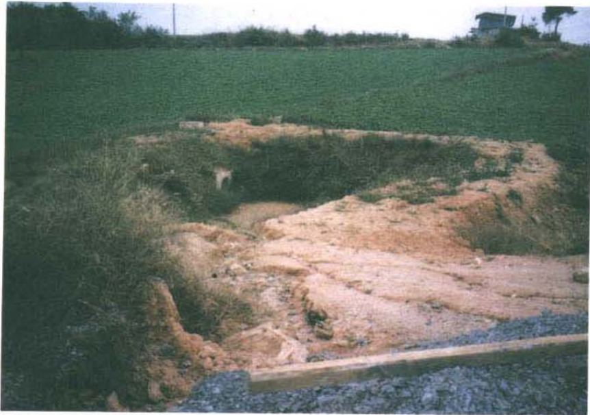
<사진 2-1> 침사지의 전경 : 토사가 침사지 하류의 논으로 유출되어 벼재배가 불가능하게 되어 휴경상태에 있다.<봉호지구>
