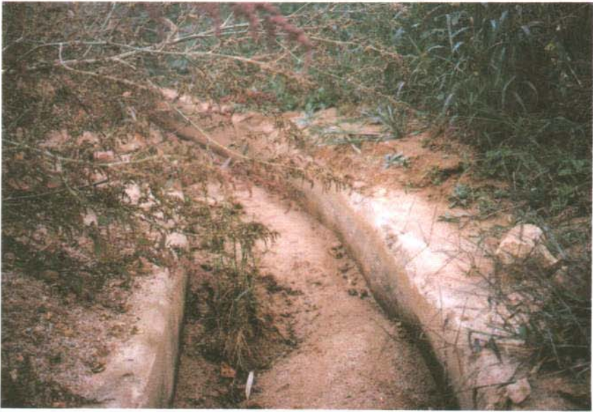
<사진 2-2> 침사지 하류 배수로의 토사퇴적 상태 <봉호지구>
