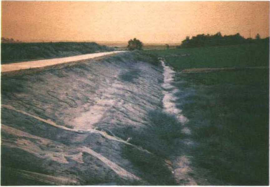
<사진 2-5> 농도사면의 토양유실 상태<봉호지구>
