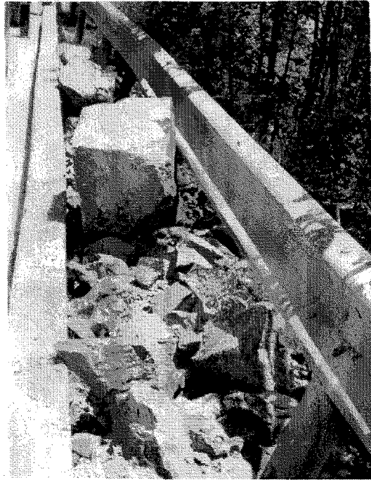
사진 2-15. 도로변에 남아있는 낙석의 일부모습 흑운모 편마암의 암석들로 암석이 단단하며 절리면이 명확하다.
