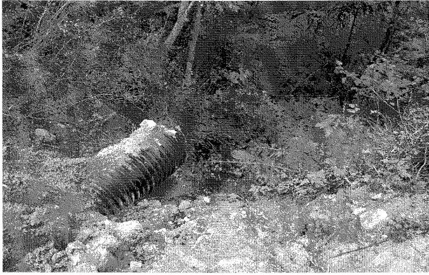
사진 2-26. 암거부 세굴로 인한 붕괴(함양 마천 삼정리)
