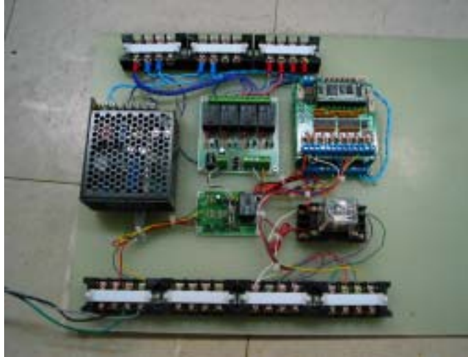
[그림 4.14] Control module - PLC
