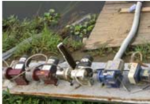
[사진 58] 유입수정량펌프(시작품) 설치
