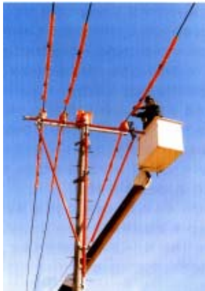
<사진 29> 플렉시블 라인호스(Flexible Line hose)가 설치된 장면
