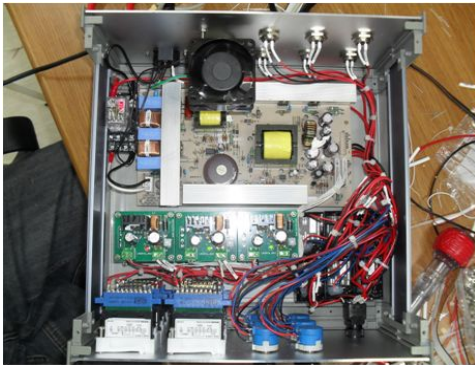
<SMPS 전원부분에 방열을 위한 FAN 설치>
