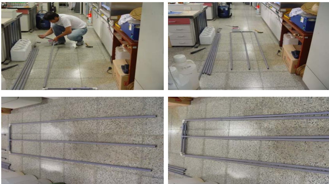
Fig. 3-21. 퇴비화조내에 설치된 공기주입장치 제작 전경.
