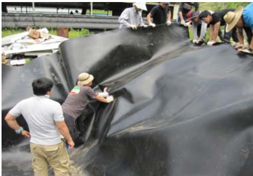
(혐기성조 호기성조와 배관 연결)
