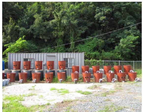
소형 축산폐수처리장치 완공전경
