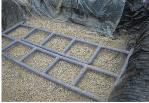
(호기성조 통기관 설치)
