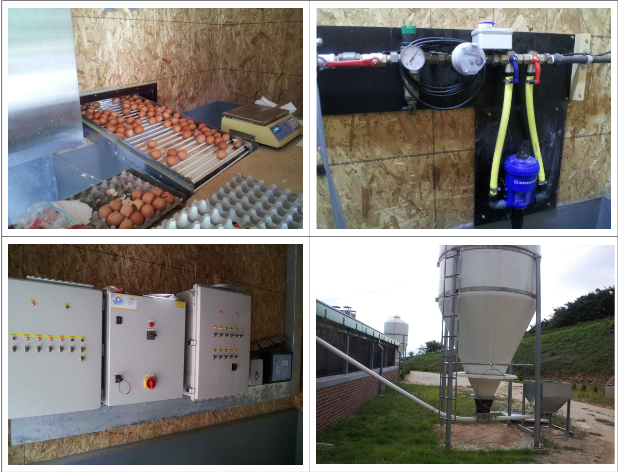
<그림1-8> 복지형 산란계사 내부 컨트롤러 및 설비
