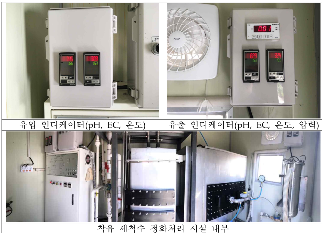
<그림 107. 센서 및 인디케이터 설치 전경>
