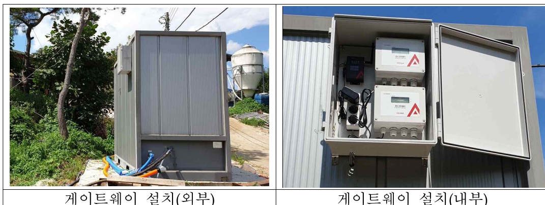
<그림 108. 게이트웨이 설치 전경>
