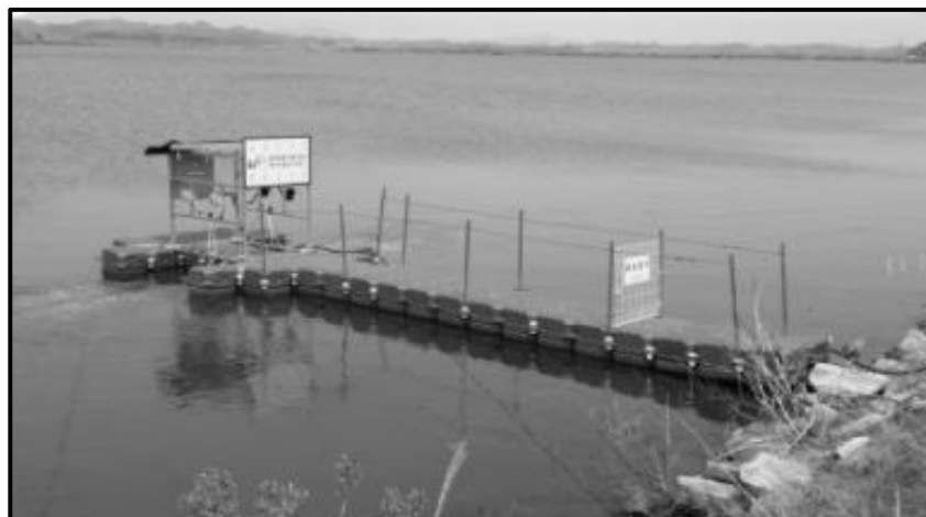
(그림 4.6-3) 산소공급장치 설치 사례(강화도 대수저수지)
