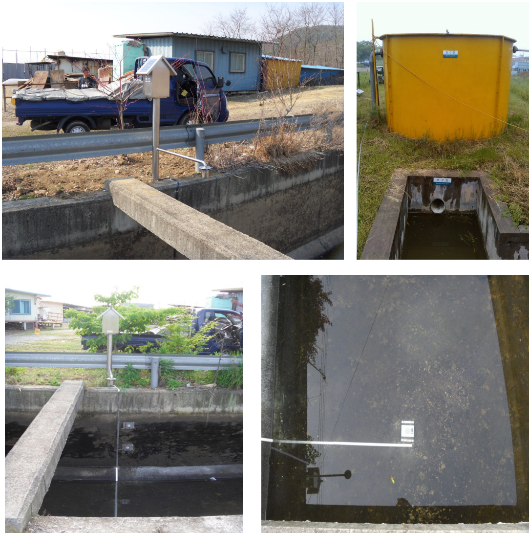
<그림 3-62> 복합 유량계 현장 설치 시험
