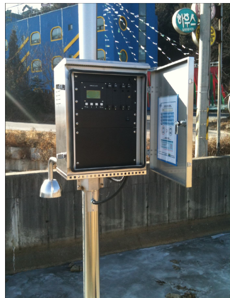
<그림 3-57> 유량계 컨트롤러
