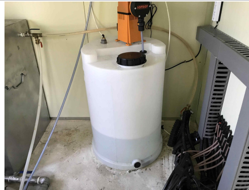
약제 탱크 및 희석 장치(펌프)
