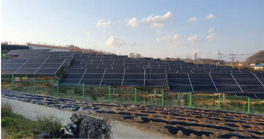
<그림 3-34> 운암면 학암리 마을단위 400kW 태양광발전소
