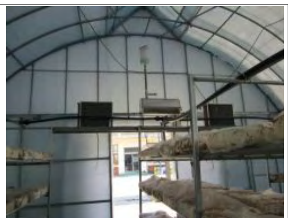
○ 재배사 내부 난방기 설치
