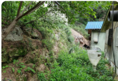
농장 뒤편에 밀폐된 울타리와 배수구가 없어 빗물 및 토사가 농장 안으로 쓸려 내려오면서 야산의 오염된 바이러스가 농장으로 들어 올 우려가 있음
