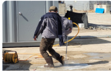
농장 내부 공사(컴포스트, 울타리 옹벽)를 위해 출입하는 인부가 방역복을 입지 않고 방역실에서 전신 소독 없이 농장에 진입함
