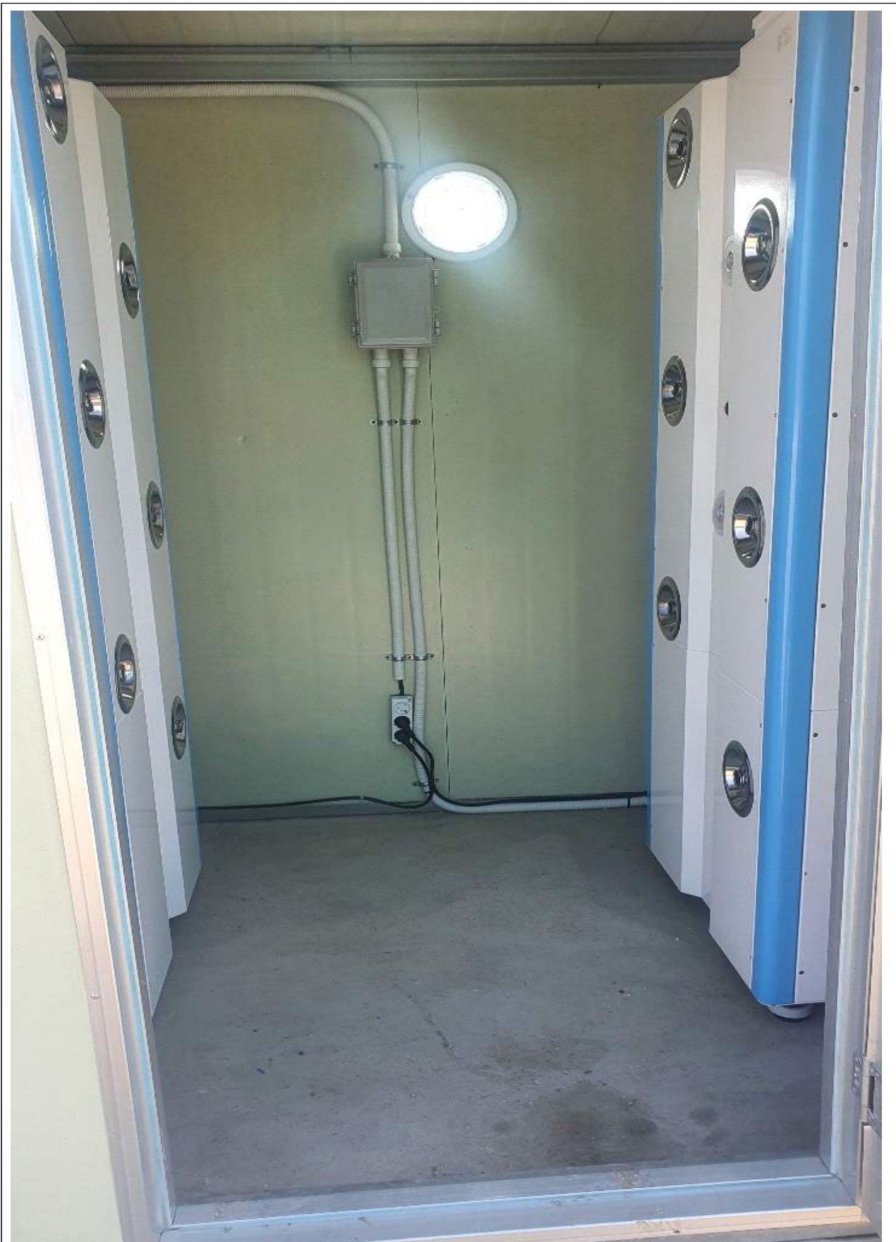
대인 소독기 현장 설치 사진
