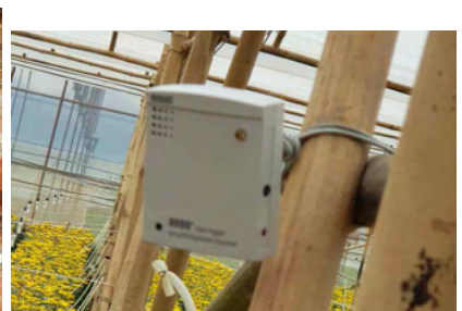
<Data logger 설치 - 3개구역>
