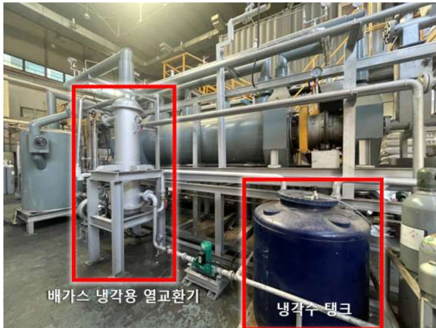
그림 2-20. 배가스 냉각용 열교환기 및 냉각수 탱크
