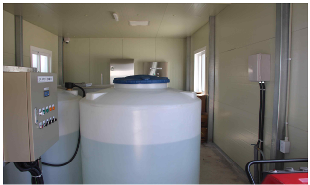
소독시설 기계실(Control box)
