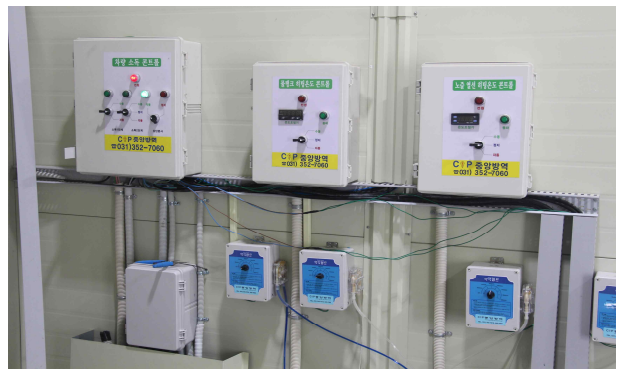
소독시설 기계실(Control box)
