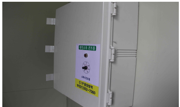
대인 소독시설(Control box)
