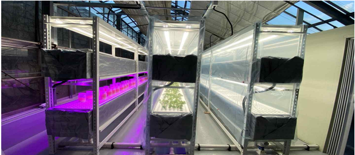
그림 52. 좌상-기존 분산 물탱크 (1톤, 직경 1.1m, 높이 1.5미터 크기), 우상- 재배단 하부 공간을 활용한 분산 축냉조, 하-수조 위 재배단이 설치된 모습
