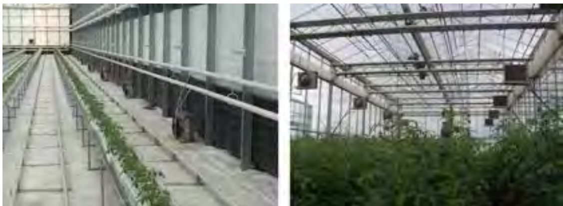
[그림 2-31] FCU 설치 전경
