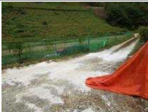
차단방역시설에 장마 대비 배수로 확보
