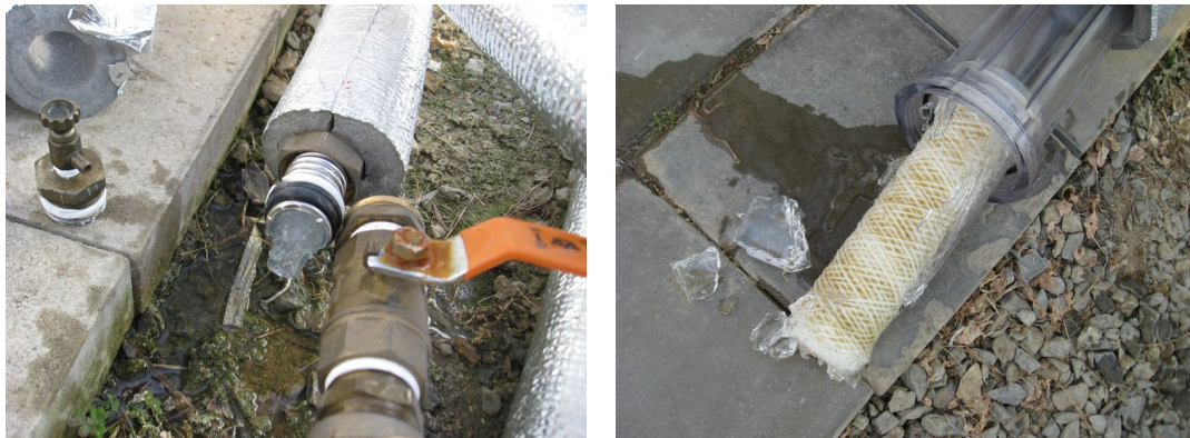
그림 91. 저온수 파이프 배관과 필터의 물이 어는 문제 발생
