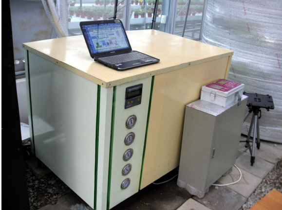
(a) 히트펌프의 외관 및 설치 위치
