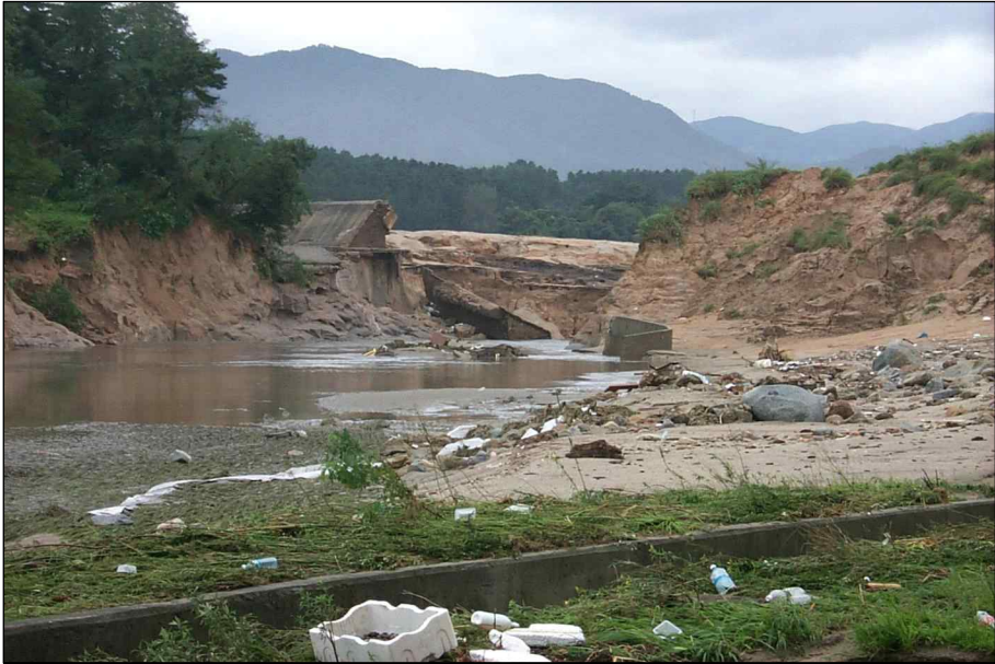
<그림 2-7> 장현저수지 여수로 붕괴 현장
