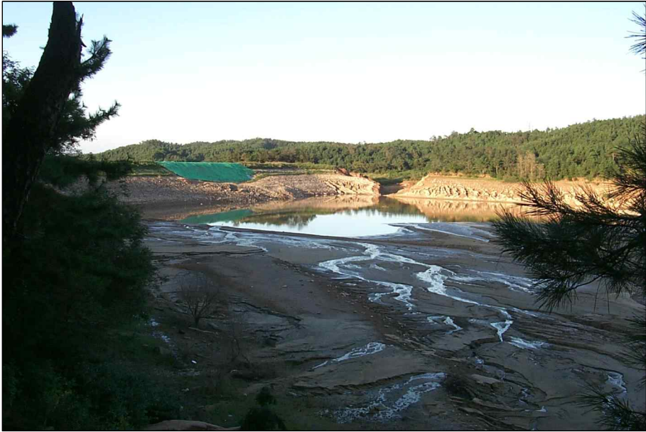
<그림 2-9> 동막저수지 붕괴 현장
