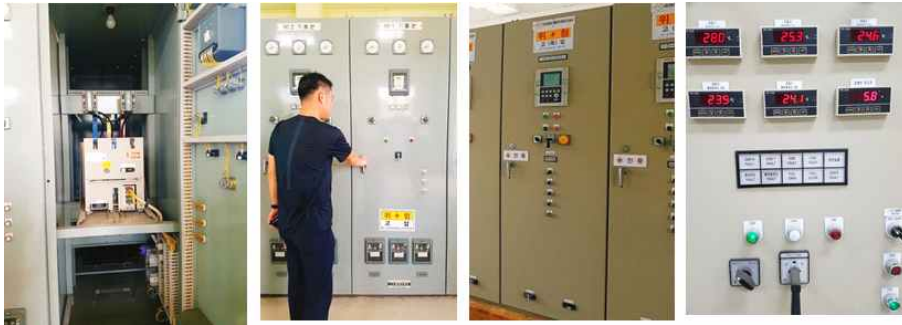
< 그림 2.31 > 다양한 수배전반(Switchgear)의 표준화 필요
