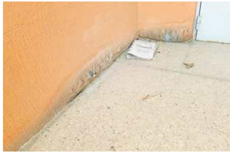
(b) 출입구 바닥경사 역구배 외장재 손상
