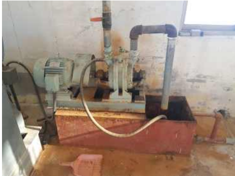
(a) 기계분야 : 펌프
