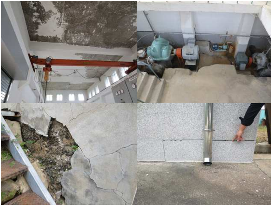
< 그림 3.22 > 천정 및 외벽, 외장재 손상 전경
