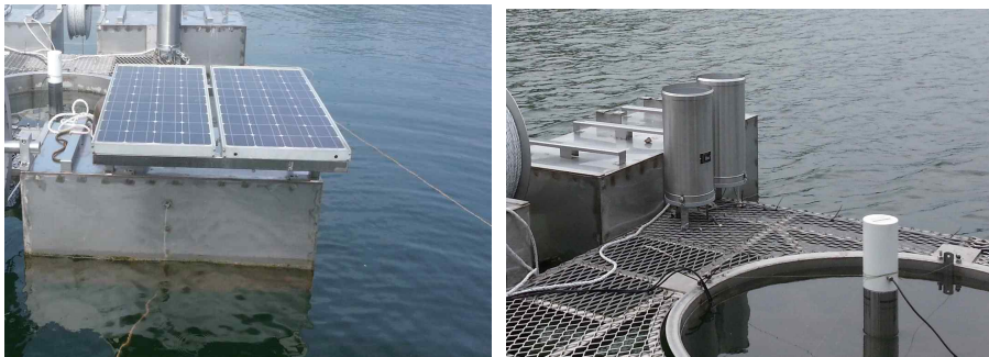
<그림 2-78> 전원공급시스템과 우량계 설치
