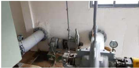
(c) 기계분야 : 펌프
