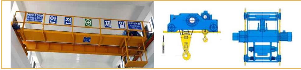
< 그림 2.14 > 천정주행기중기(Over head crane)
