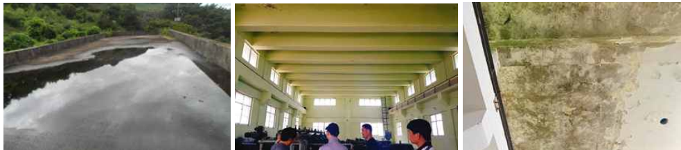
< 그림 2.32 > 양·배수장 본체 최상부 슬래브(지붕) 배수, 도장 상태
