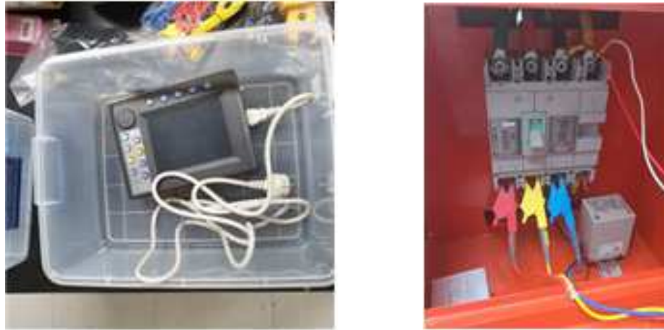
그림 5. 소비전력 측정기 및 설치모습
