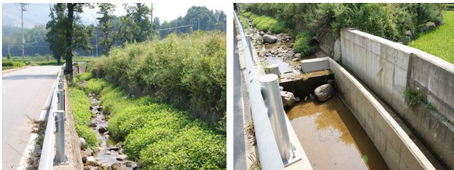
<그림 3-34> 자연스러운 배수로 경관과 단절된 수리구조물
