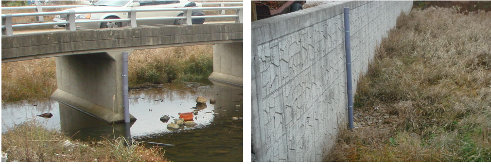
<그림 4.16> 고성군 하이면(봉현천) 하천 상하류 수위계 설치 후
