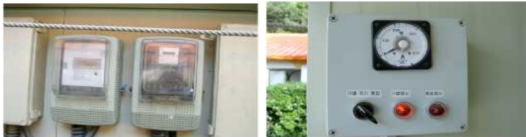
<광일농장에 배치된 발전전력 변환장치>
