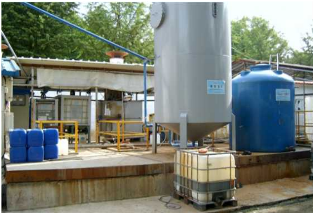
정화처리시설 설치 및 운영 중(안성 광일농장)
