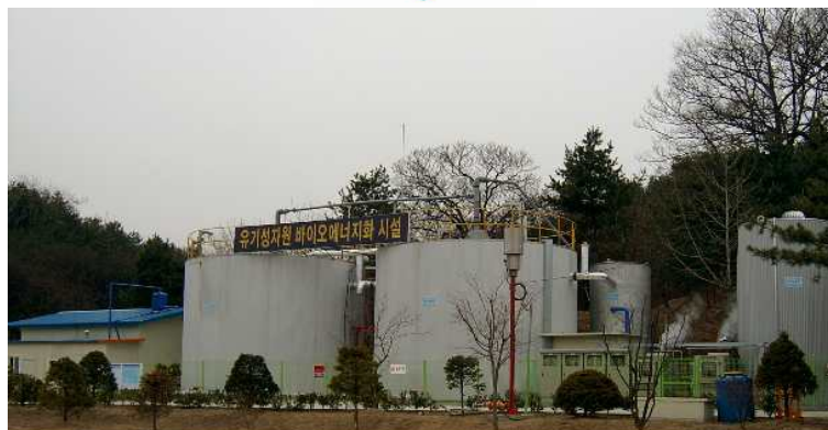
최종연구 개발결과물(일 20톤 규모, 안성 광일농장 설치)
