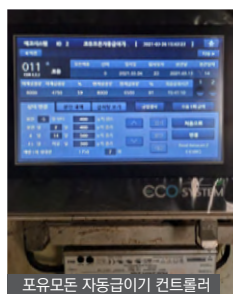
포유모돈 자동급이기 컨트롤러
