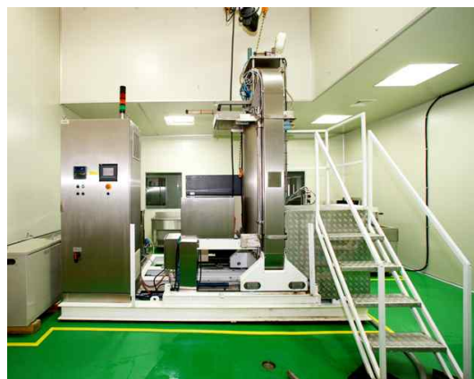
Figure 12. 초고압 장치 (전남 나주 생물산업지원센터 소재)
