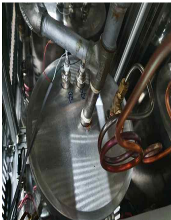
초고온 과열 증기 발생 장비 내부 전경
