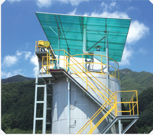
컴포스트 설치 전경
