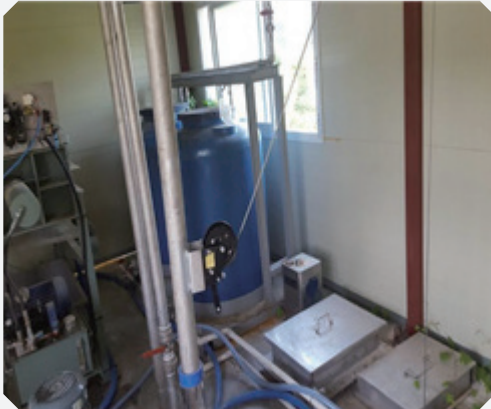
약품 반응 탱크 및 수중교반기 인양대
