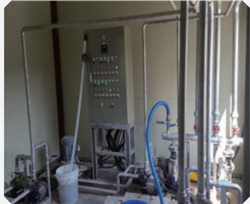
통합판넬 및 원수 이동 배관, 반응조 교반감속기 및 브로워 설비 등
