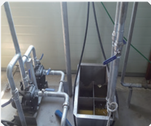
유량조정조->탈질조 이송펌프, Bypass 배관 및 V-notch(막분리조 → 탈질조 반송)
