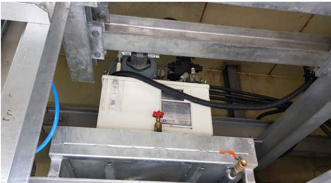
<그림 46> 로봇팔 유압펌프 설치 위치
