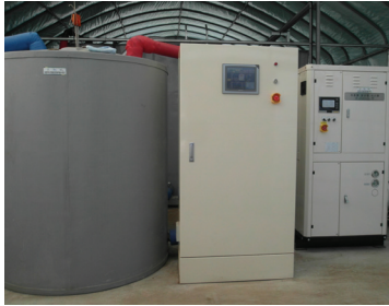
국화 지중저수열시스템 (TRHP-300W(30RT))
