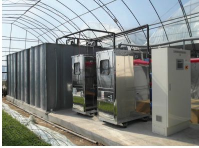
토마토 지중저수열시스템 (TRHP-400W(40RT))
