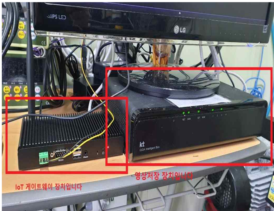
그림 10. 테스트베드 제어실 내부의 IoT 게이트웨이, 영상저장 장치
