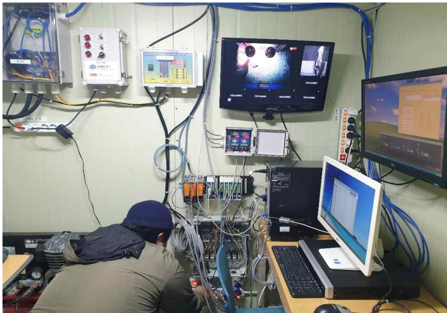
그림 6. 축사 테스트베드 제어실 내부 모습
