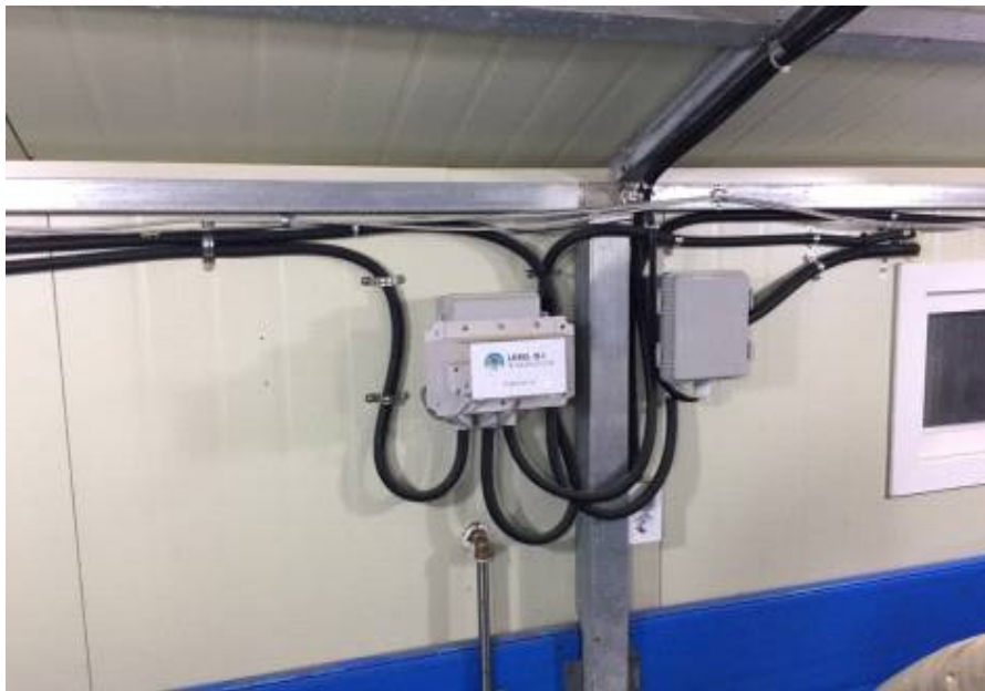
그림 13. 테스트베드 내부에 이산화탄소, 황화수소, 온습도 센서 설치
