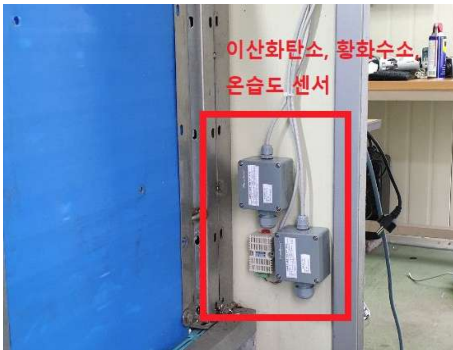
그림 8. 테스트베드 내부에 이산화탄소, 황화수소, 온습도 센서 설치
