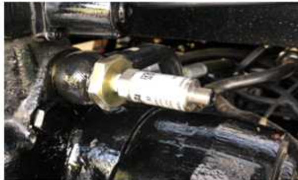
[유압 계측 센서 및 설치 사진]
