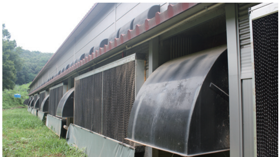
축사 외벽에 설치된 공기 환기 장치
