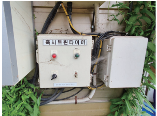
축사트윈타이머를 이용하면 계사 내부 온도 조절이 편리하다.
