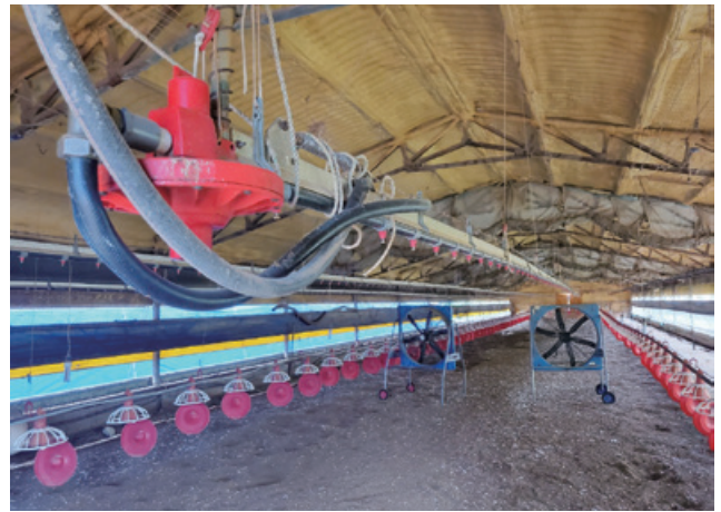
자동 급수시설, 사료급여기, 환풍기가 설치된 축사 내부 전경
