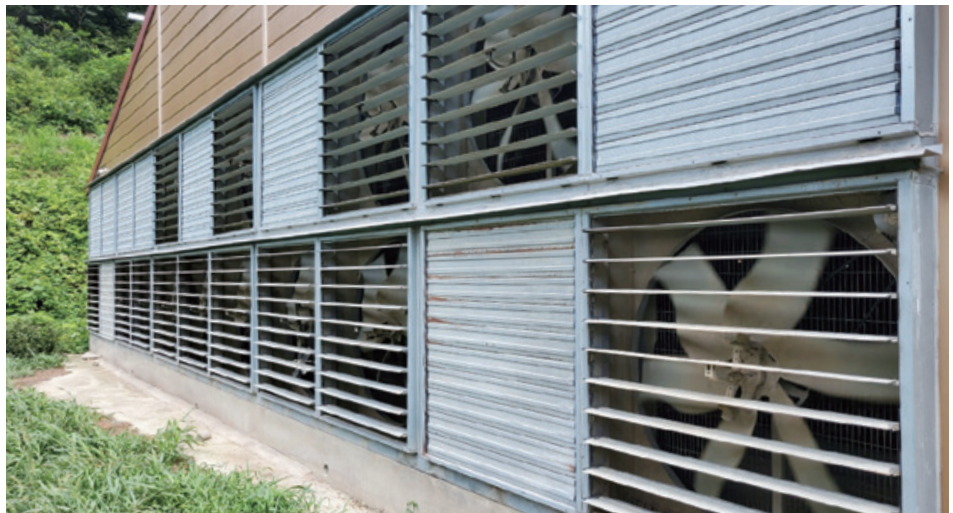
계사에 설치된 환풍기. 환풍기 가동을 통해 계사 내 공기를 쾌적하게 만든다.
