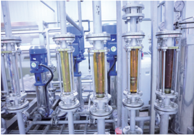
가축분뇨 정화처리시설 기계 단계별로 정화 중인 축산분뇨 오수
