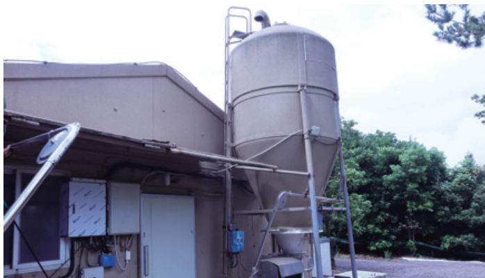
농장 전경 노블스톤 뿌려진 축사외부에 사료빈온도조절장치 설치돼 있음. 곳곳에 나무도 식재돼있음
