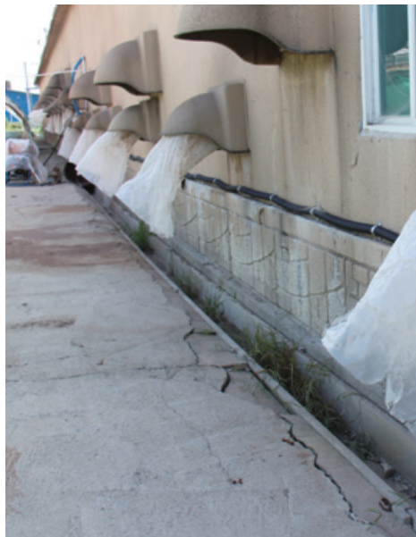
돈사 외벽에 설치된 환기 장치
